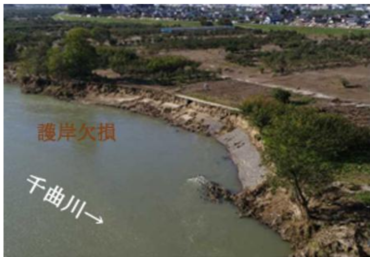
千曲川 低水路河岸侵食の様子 1) (57.8km)
