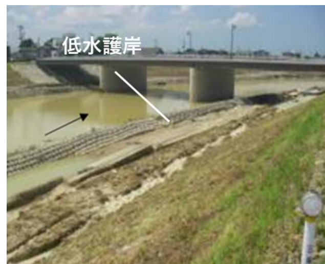
五十嵐川 高水敷洗掘（1.1km右岸） 2)
