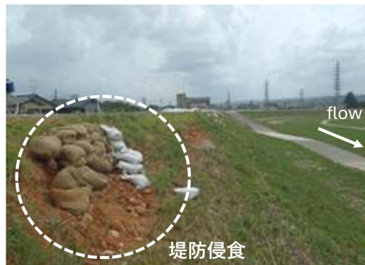
五十嵐川 H23年洪水時 堤防侵食 2)
