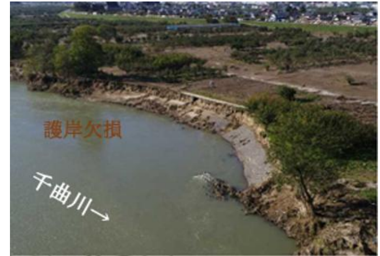
低水路河岸侵食の様子 1) (57.8km)
