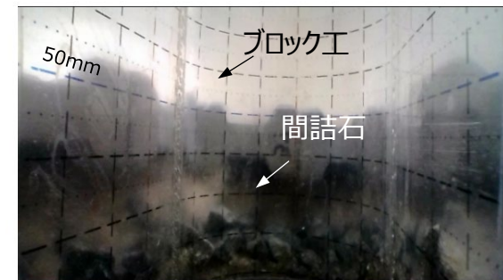
181min 間詰石の沈下・基礎部天端露出
