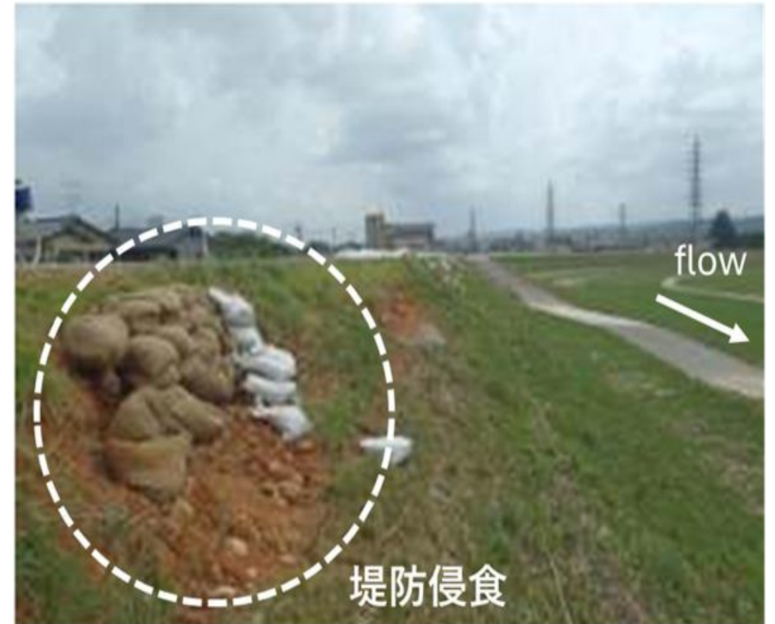
(b) 外岸表のり面侵食（3.4km外岸）
