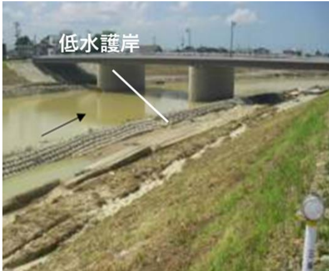
(a)内岸高水敷洗掘・低水護岸破壊（1.1km内岸）
