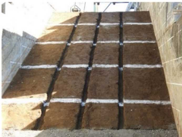
縦溝の状況 (ケース2,4)
