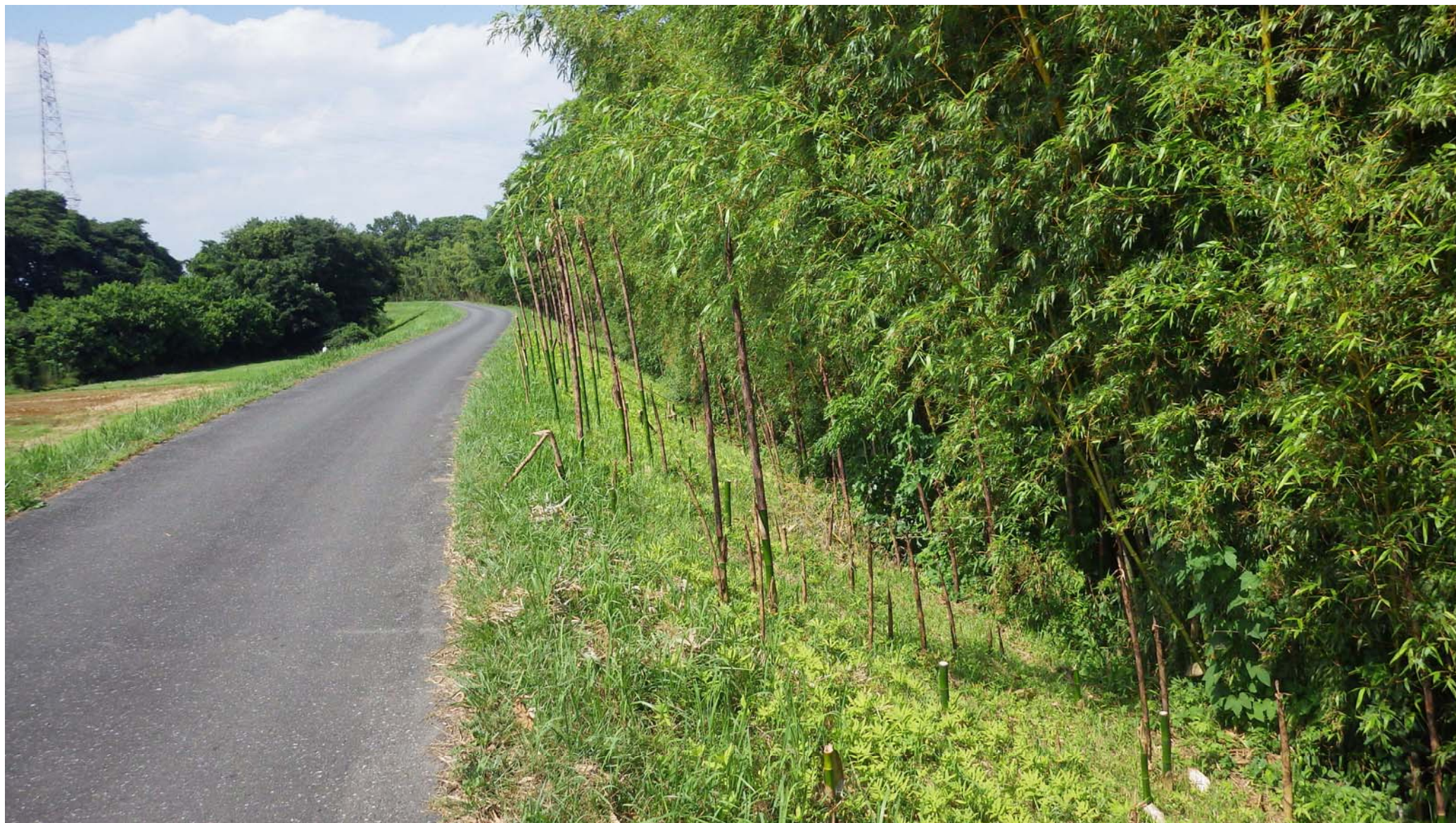
写真-1：鬼怒川の堤防川表に竹が侵入している状況
