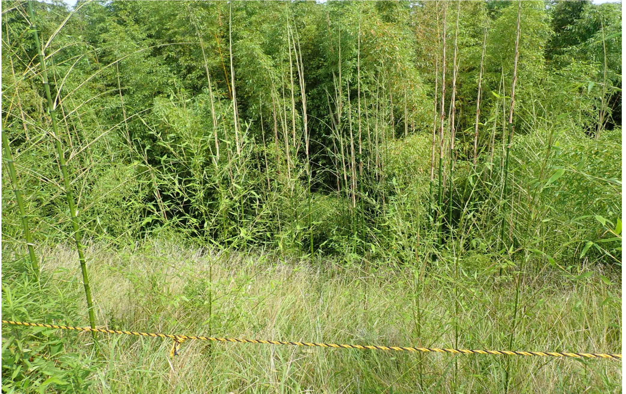
写真一2：堤防の川表法面に竹が侵入し高水敷は全く見えない状況
