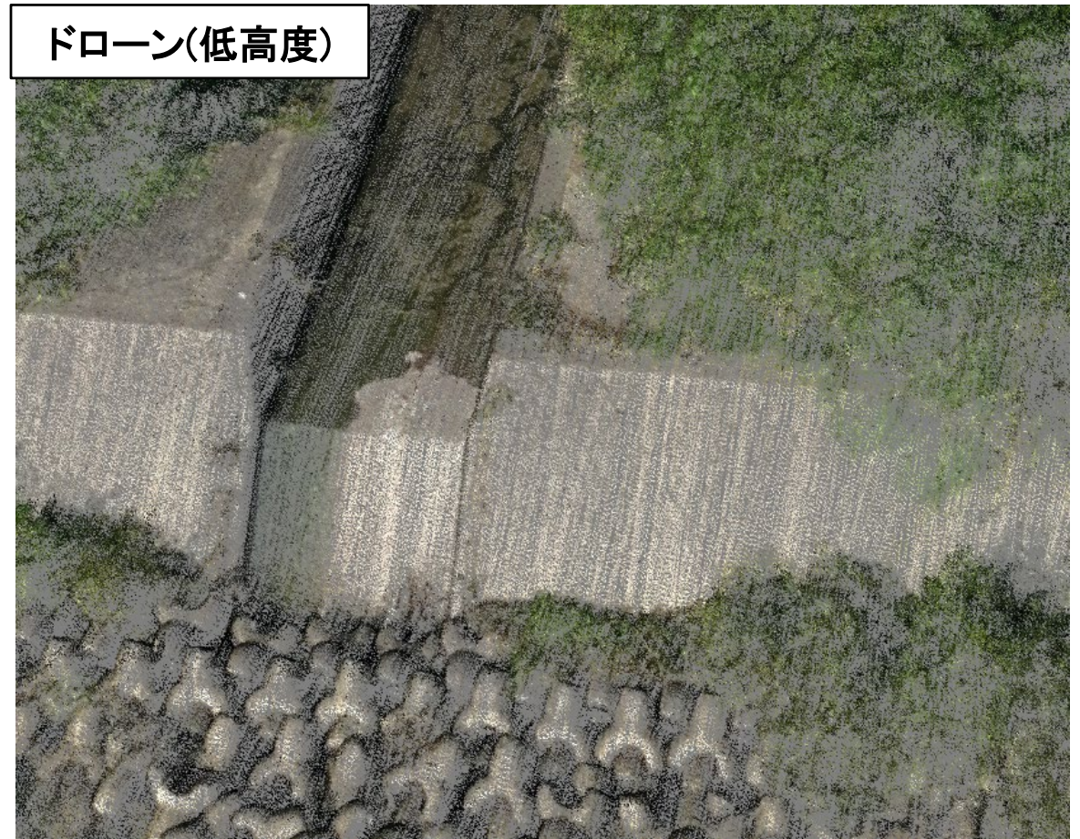
変状箇所①の川面取付護岸の クラック周辺の点群による拡大画像(ドローン)
