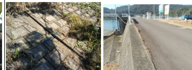
川表の護岸の小口止めの沈下 (天端クラックからの雨水が原因と推察。)
