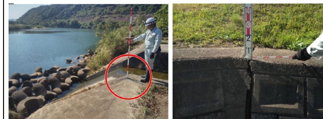
川表取付護岸の亀裂 (樹木成長により拡大の恐れ。函体に損傷なし。)
