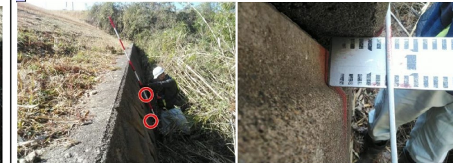
川裏のブロック積みのはらみだし (進行なし。周辺及び表法面に異常なし。)
