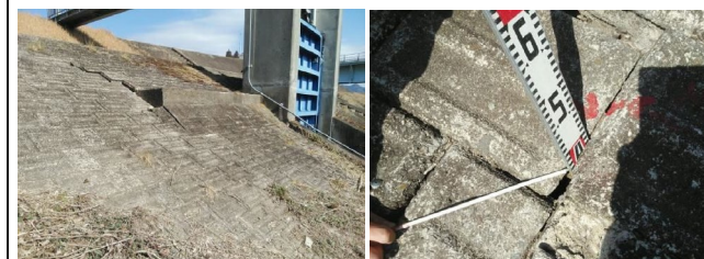
川表の胸壁部周辺の護岸沈下 (護岸尻部に土砂堆積。雨水による裏込材の流出と推察)
