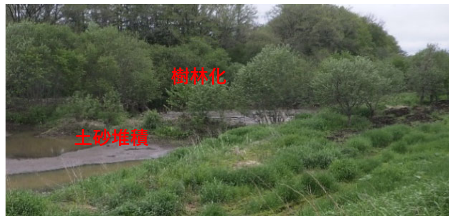
図-13 水制工部土砂堆積状況
