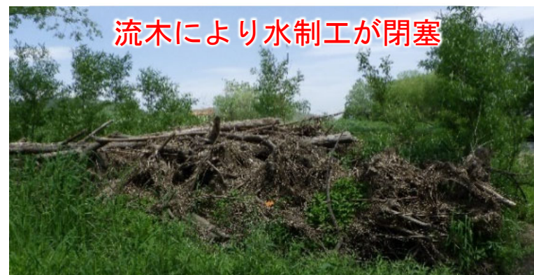
図-15 透過水制部流木による閉塞状況
