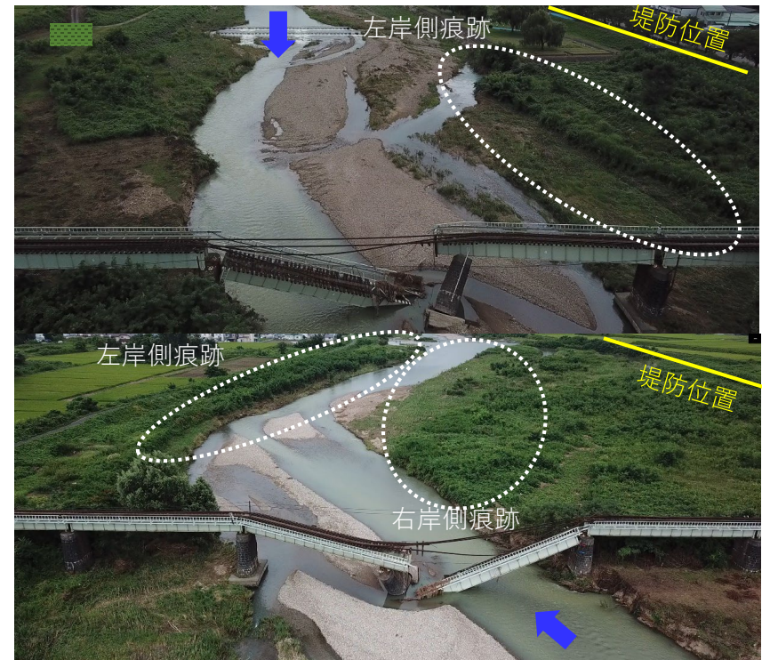
洪水痕跡 (上：上流側、下：下流側)
