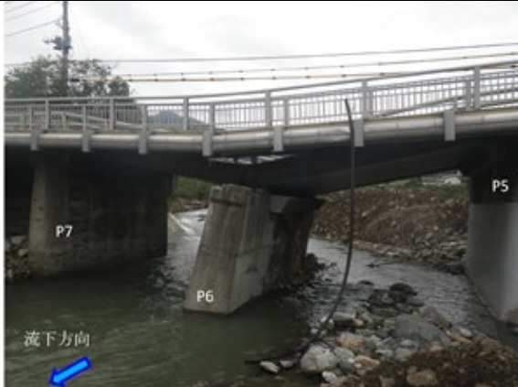
法雲寺橋の沈下 (2019年)
