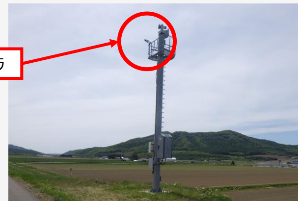
高水敷撮影用 左岸堤防上のCCTV柱
