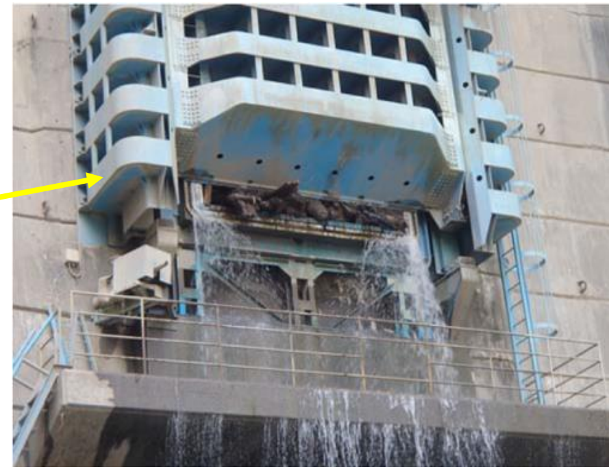
閉塞した裾花ダムの常用洪水吐きゲート (MLIT, 2018)
